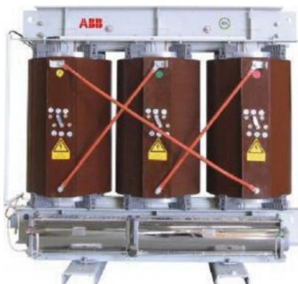
Transformador MT ( ABB)
